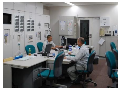
設備の24時間監視
