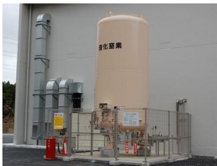
屋外液体窒素補充用タンク
