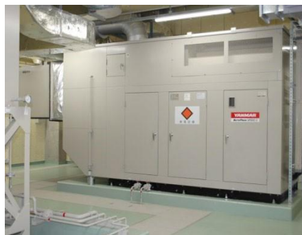
自家発電装置（毎月運転確認を実施）
