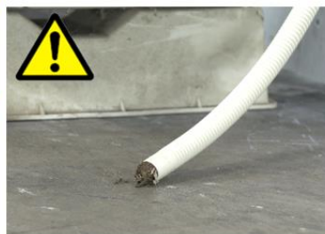
排出口が詰まっている状態
