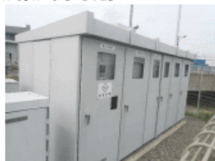
【図1】キュービクル(高圧受電設備)
