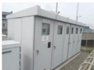
〔図1〕キュービクル（高圧受電設備）
