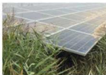
〔図 2〕台風時の水害により施設が水没した事例 出典：「太陽光発電の環境配慮ガイドライン」（環境省）
