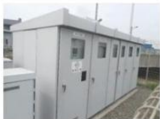
〔図1〕キュービクル（高圧受電設備）
