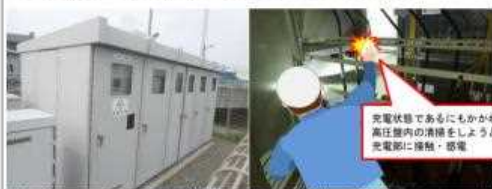
【図1】キュービクル（高圧受電設備）
