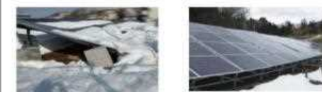
【図1】積雪による太陽電池発電設備の破損
