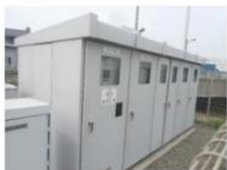
〔図1〕キューピクル（高圧受電設備）
