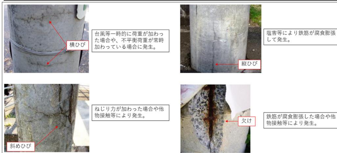
図4 鉄筋コンクリート柱のひび割れ例
