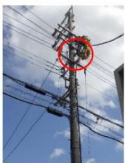
写真1 波及事故発生現場
