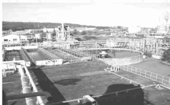
排水処理設備
